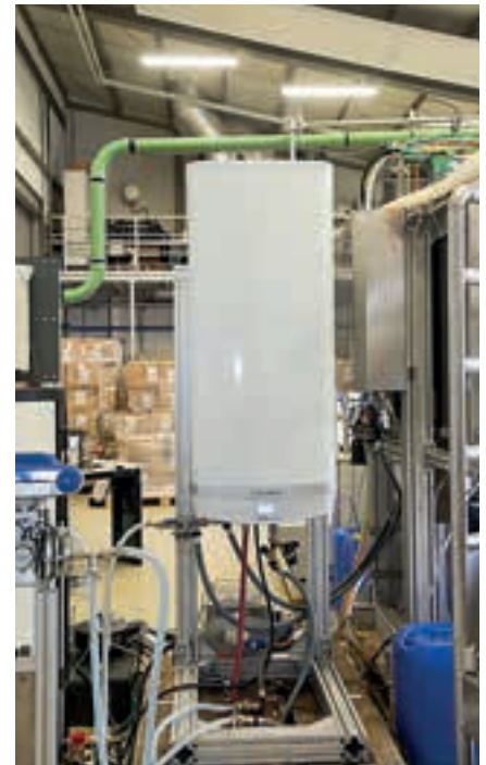
Αυτή τη φορά, ο θερμοαντήρας νερού ήταν σημαντικά μικρότερος, καθώς χωρά 120 λίτρα.
