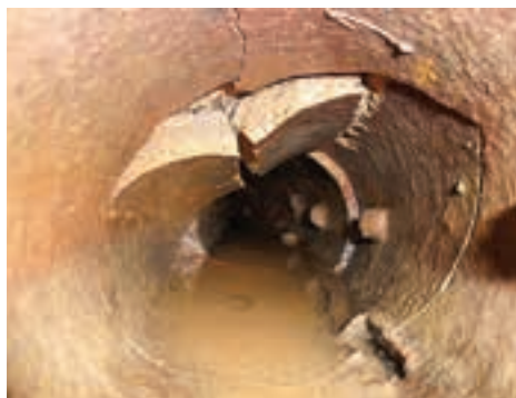
Παρακολούθηση με κάμερα δείχνει τυχών βλάβες στους σωλήνες.
