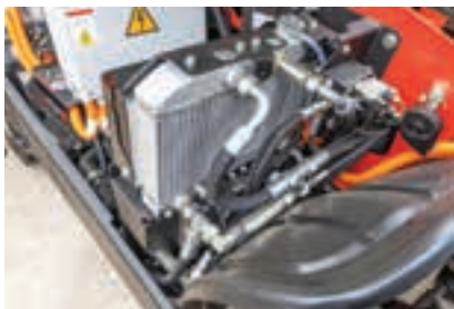
Ο πλευρικός θάλαμος φιλοξενεί κεντρικά ηλεκτρικά τμήματα όπως μετατροπείς, μονάδες ψύξης, μαζί με δεξ. 80 λίτρ. λαδιού.
